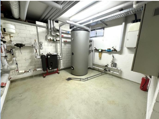
Heizungsraum des Hauseingangs (Zentrale separat)
