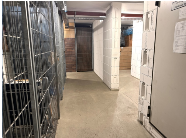
Kellerboxen mit separaten Stromanschlüssen je WE
