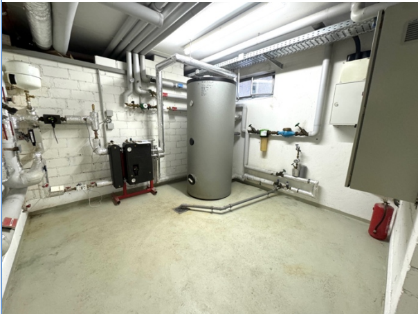
Heizungsraum des Hauseingangs (Zentrale separat)
