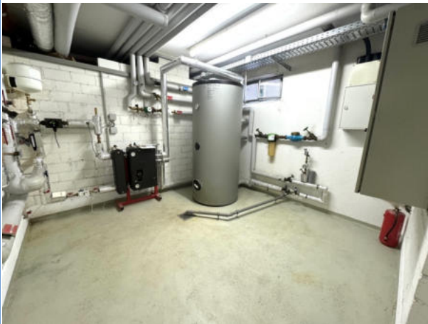
Heizungsraum des Hauseingangs (Zentrale separat)
