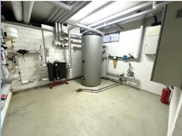
Heizungsraum des Hauseingangs (Zentrale separat)
