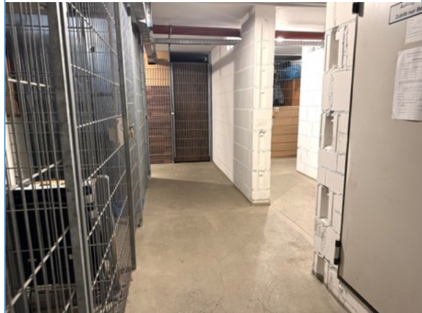
Kellerboxen mit separaten Stromanschlüssen je WE
